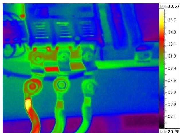
Рисунок 21. Пример термограммы контактных соединений с температурной шкалой
