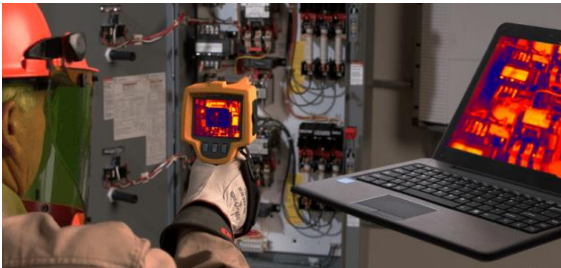
Рисунок 20. Пример проведения тепловизионного контроля электрошкафа
